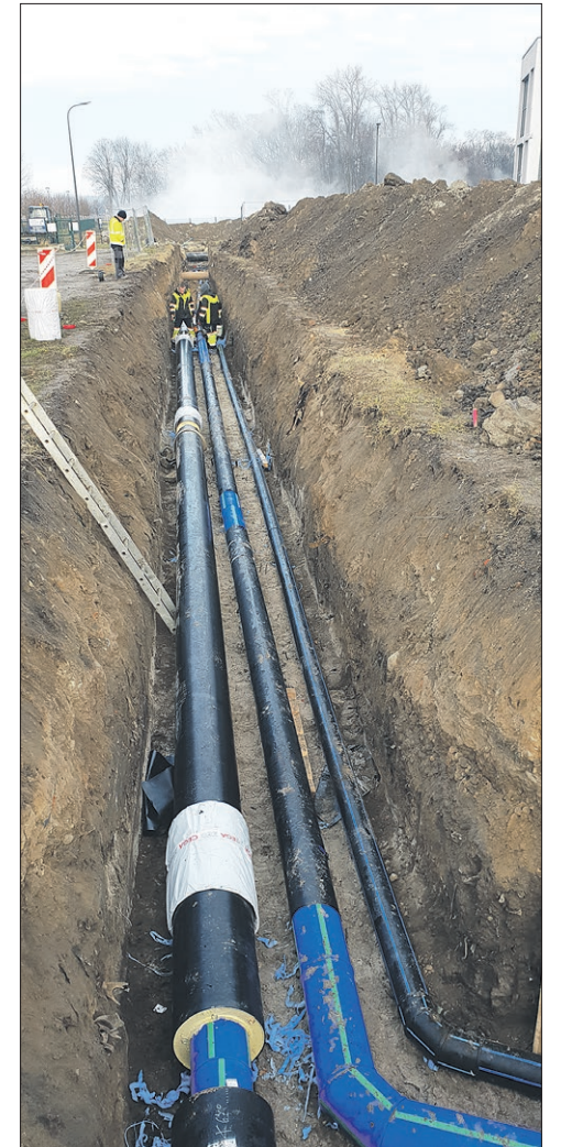
Przyłącza wody termalnej z geotermii do basenów
